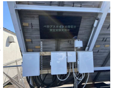
傾斜面裏には蓄電ボックスが
